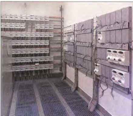
Bild 10: Stromzähler für die einzelnen „Untermieter“ der Sendeanlage Kronplatz
